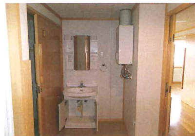
洗面脱衣室(ガスボイラー)
