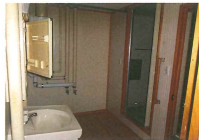
洗面脱衣室(ガスボイラー)
