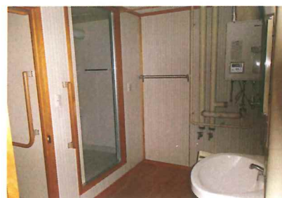
洗面脱衣室(ガスボイラー)
